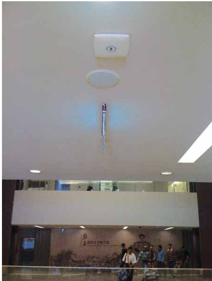
圖二 國立故宮博物院正館展廳室內無線網路基地台
