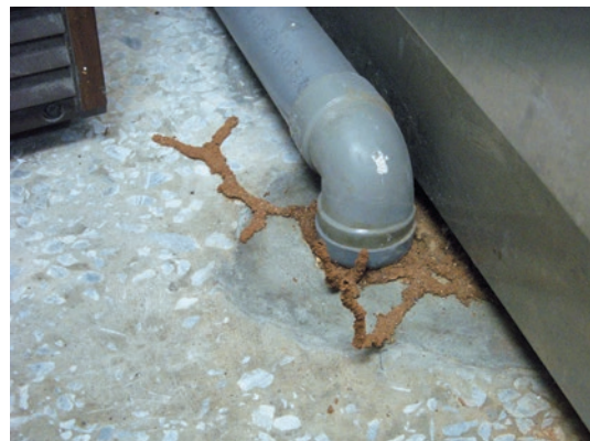
圖 5 地下白蟻族群可能循現成管道間入侵建築物。 作者攝
