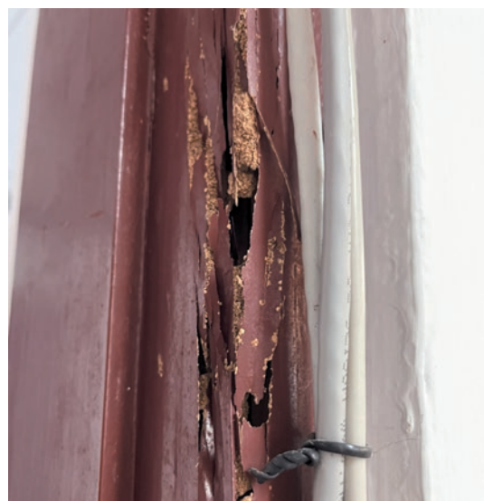
圖 4 門框被白蟻危害，以工具探戳僅剩下表面薄薄一層，內部已經被吃空。 作者攝
